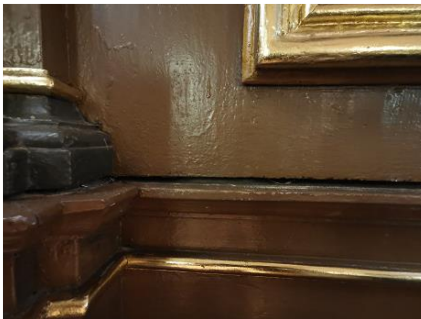
Spękania z przemieszczeniem konstrukcji architektonicznej ołtarza.
