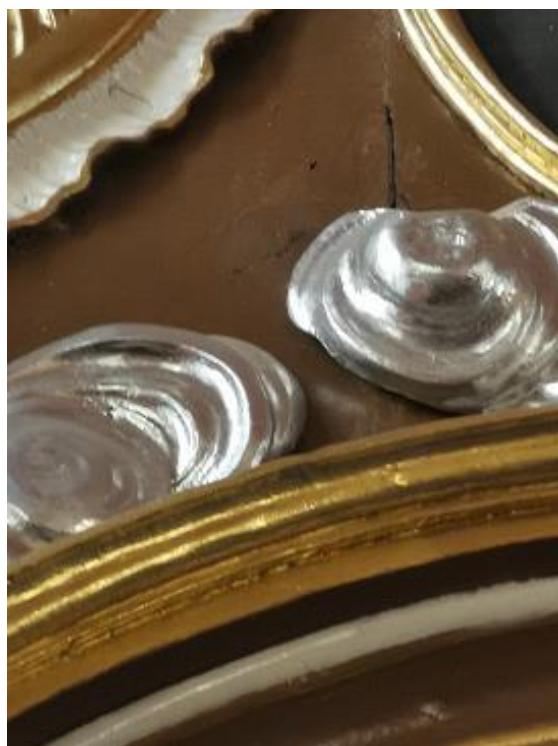
Spękania konstrukcji architektonicznej ołtarza
