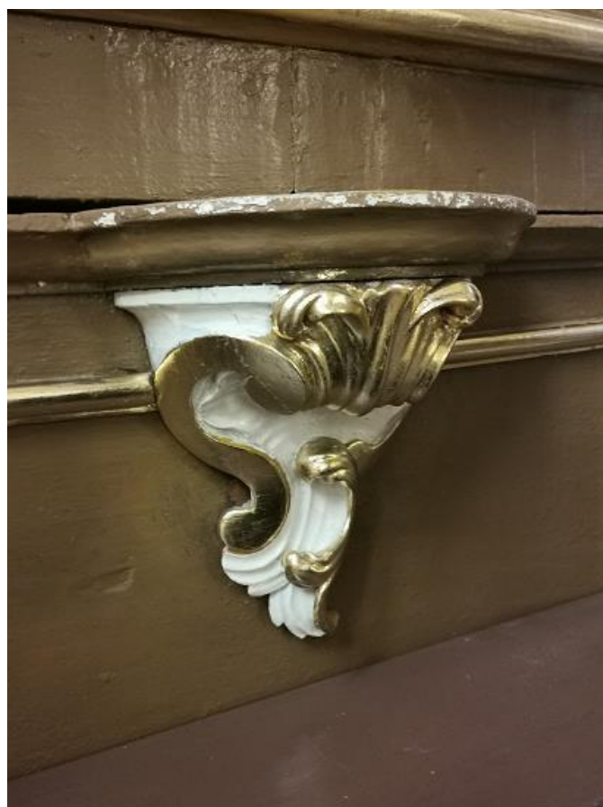
Spękania z przemieszczeniem konstrukcji architektonicznej ołtarza.
