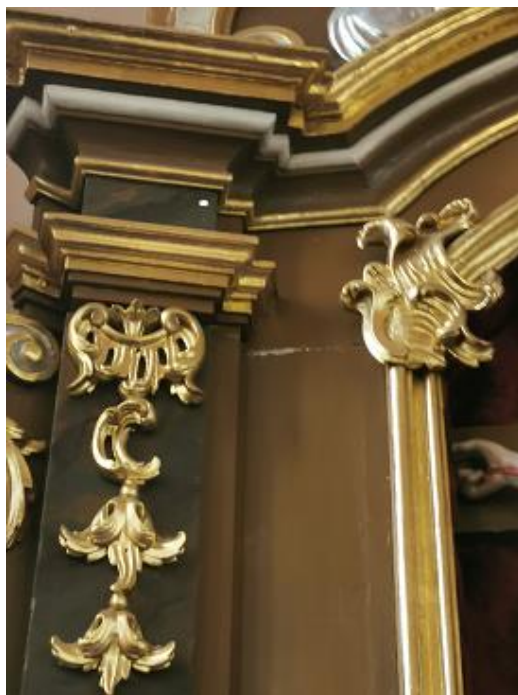
Spękania konstrukcji architektonicznej ołtarza
