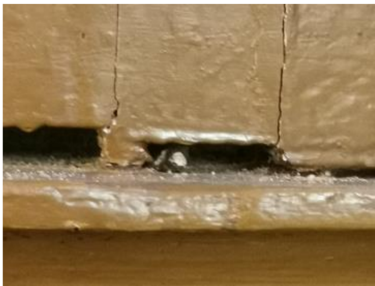
Spękania z przemieszczeniem konstrukcji architektonicznej ołtarza.
