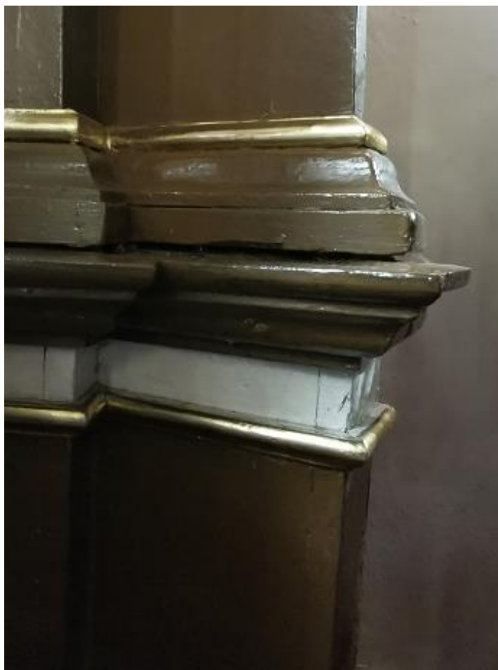
Spękania z przemieszczeniem konstrukcji architektonicznej ołtarza.
