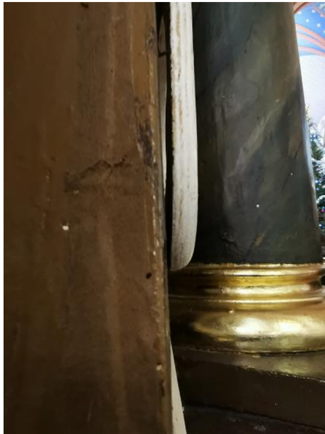
Przemaalowania zniszczonej struktury architektonicznej.
