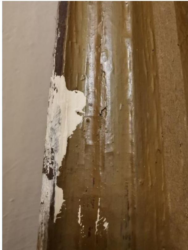
Zniszczenia struktury architektonicznej ołtarza ubytki malatur ,
