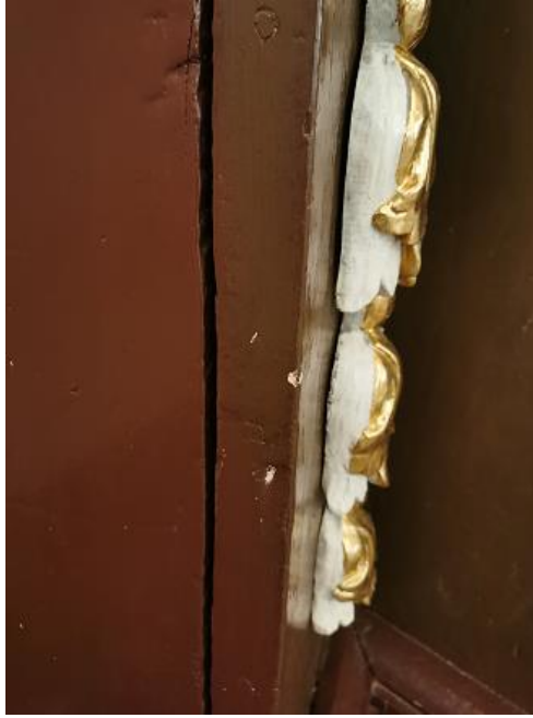
Zniszczenia struktury architektonicznej ołtarza ,
